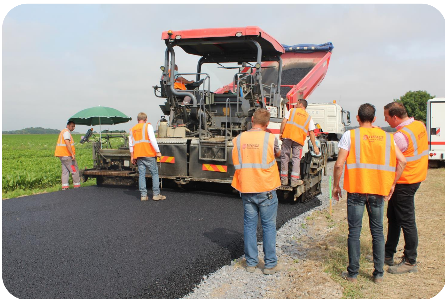
2 800 tonnes d'enrobé ont été utilisées pour la portion de route entre Levergies et Ramicourt
